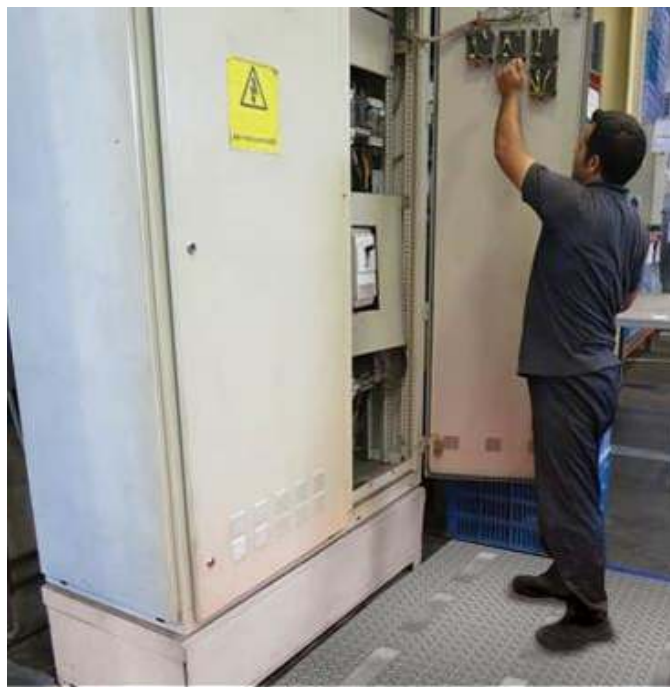
درپوش قفل دار تابلو برق و کف پوش عایق
