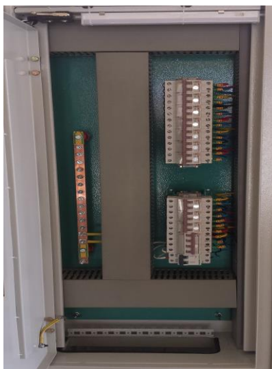
شکل (۷): نمایی از بخش خروجی تابلو
