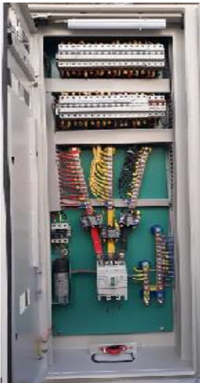
شکل (۲) : نمایی از بخش ورودی تابلو و نحوه چیدمان تجهیزات
