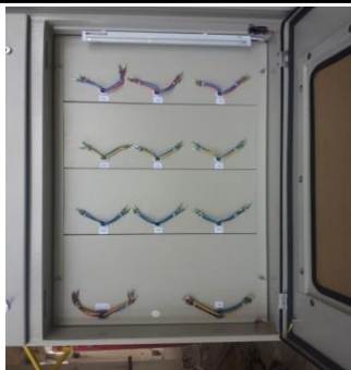
شکل (۶): نمای صفحه نگهدارنده کنتورها پس از سیم کشی
